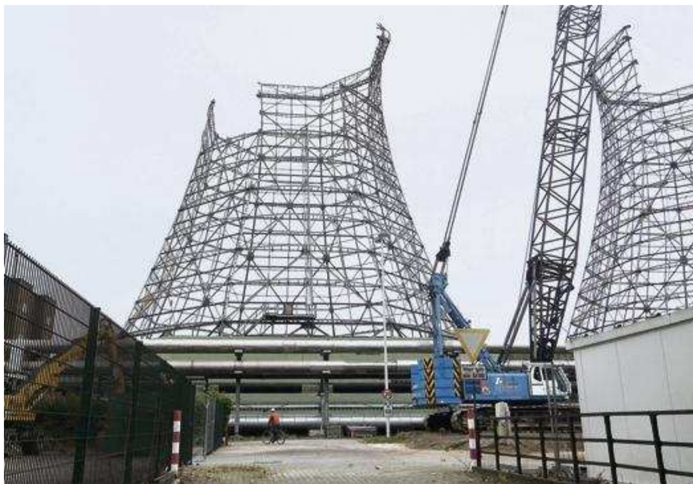
Tours de refroidissement de la station à charbon de Herne, en Allemagne, en décembre 2014. PATRIK STOLLARZ/AFP
